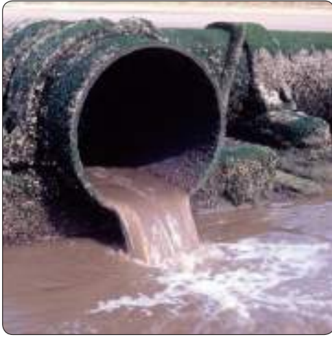
شكل (١١٧) إحدى قنوات الصرف الصحي
